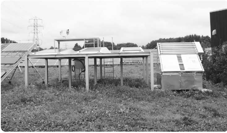
北杜サイトに設置された太陽熱利用研究施設
