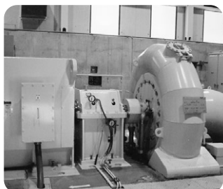
県営塩川ダム水力発電施設
