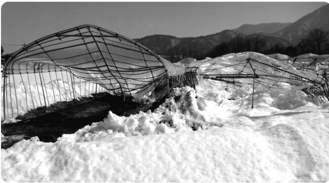
倒壊した育苗ハウス (白州町地内)
