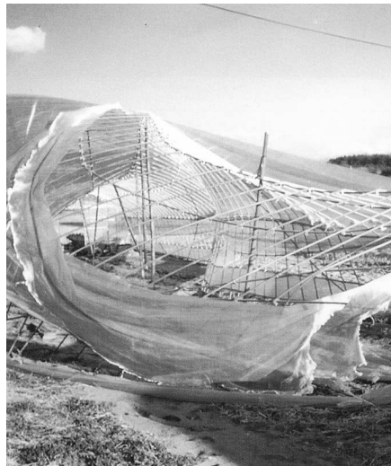
ビニールハウスの暴風被害
