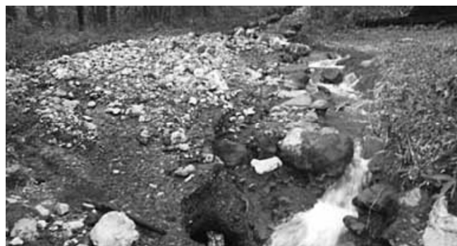
大泉町地内の林道が洗掘
