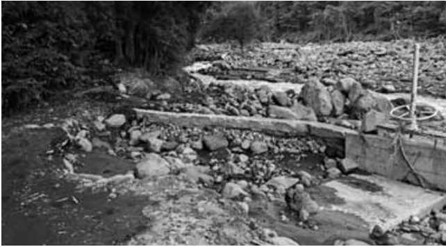
市内の各所で用水の取水口が損壊
