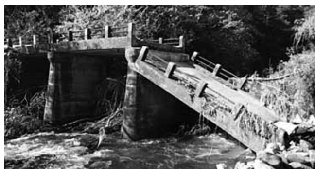
鳩川にかかる市道の逸見原橋が落下
