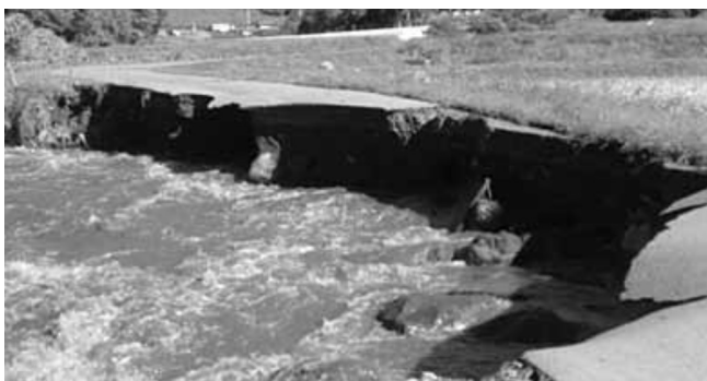
鳩川沿いの農道が一部崩落
