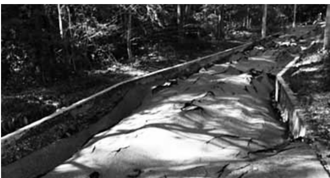
小淵沢町白樺平分譲地に接続する道路が崩壊
