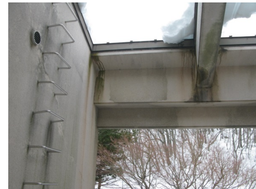
躯体打ち込み部き裂
