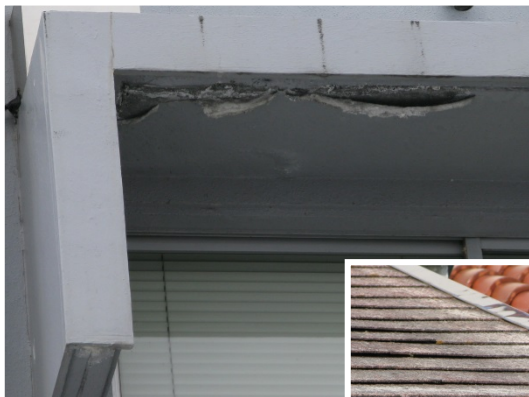
底部分の劣化・破損
