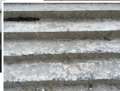
コンクリートの劣化
