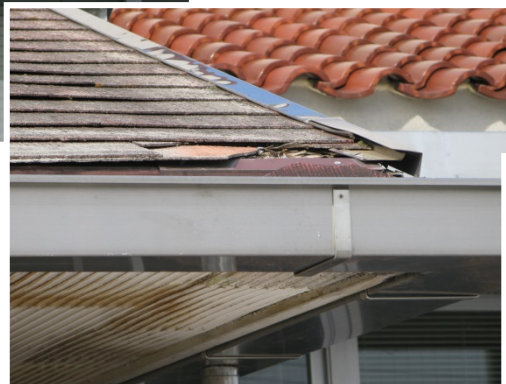
玄関ポーチ屋根材破損
