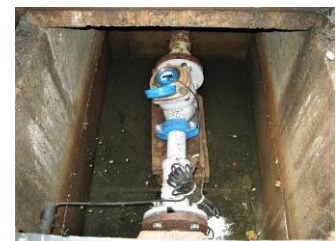
傾いたメーター
