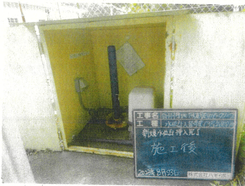
S&DL水位計普及型設置・設定 3号観測井
