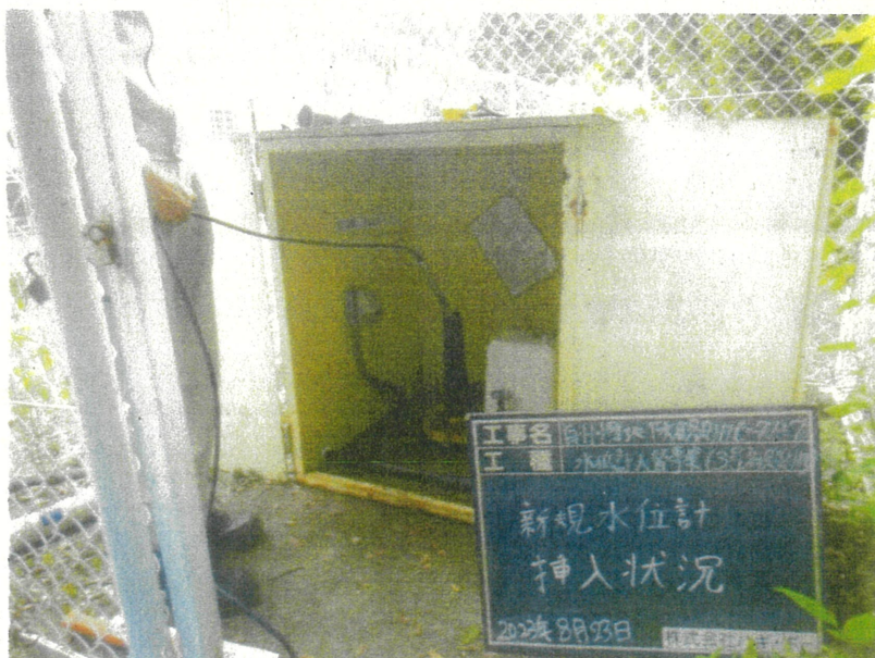
S&DL水位計普及型設置・設定 3号観測井
