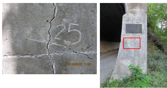
境之沢隧道：坑門のひび割れ
