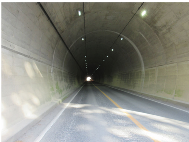
写真3 LED取替後の大穴トンネル
