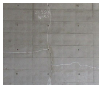
小淵沢カルバート：側壁のひび割れ
